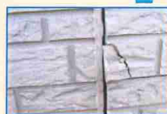
シーリングの剥がれ
